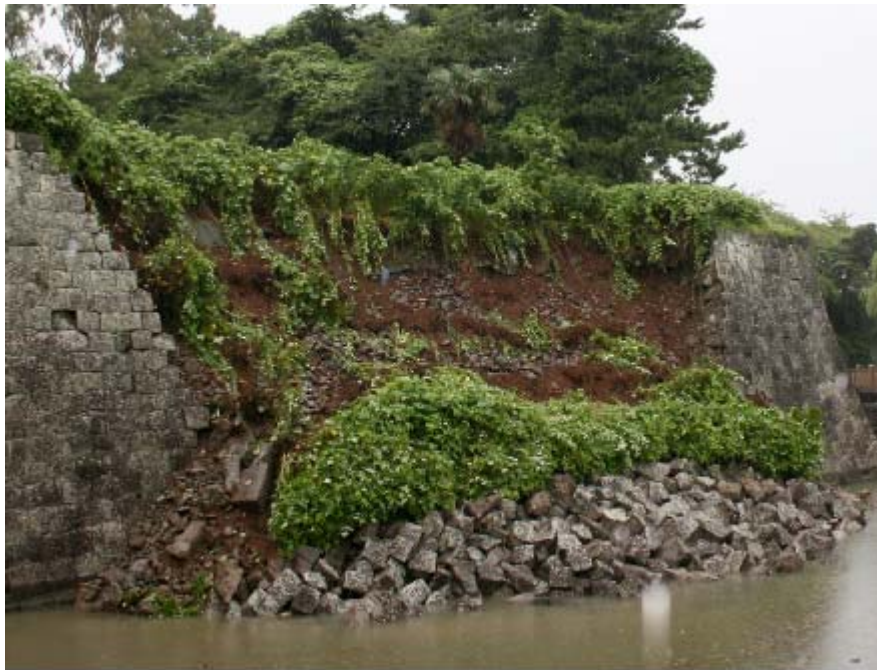
地震で崩れた静岡県庁前の石垣
