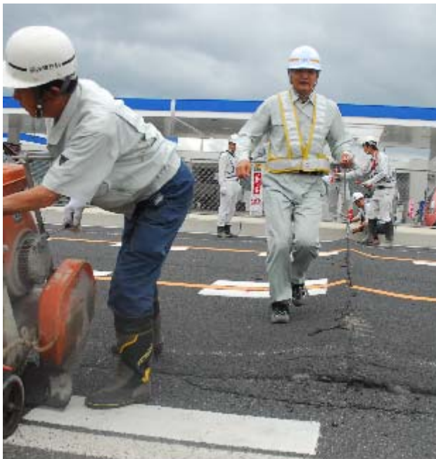
国道112号の地面が隆起し、通行止めの規制が敷かれた中山町長崎の現場
